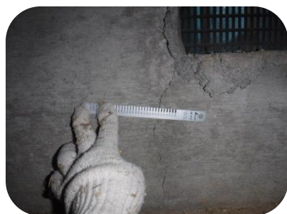
ひび割れ発見
